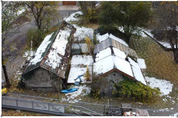
1// fotografia del manufatto nel contesto naturale 2// fotografia delle due forme principali con costruzione in pietra e coperture a falda doppia. Lo stato di degrado, soprattutto del tetto, è ben evidenziato
